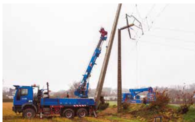
Les tempêtes de l'hiver 2019 ont causé de gros dégâts sur le réseau électrique.
