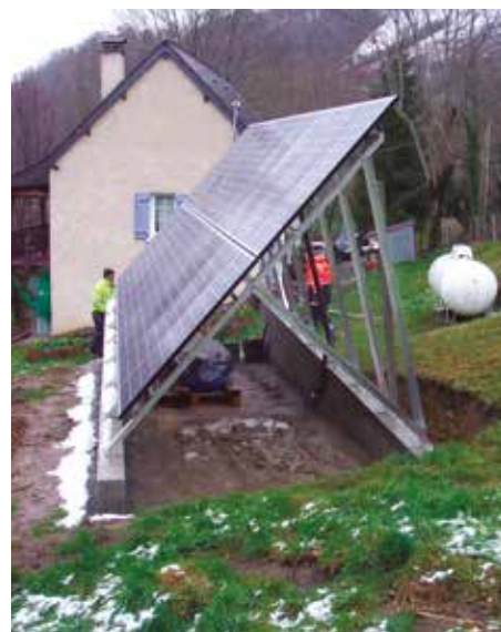
Installation solaire à LOUVIE-SOUBIRON.
