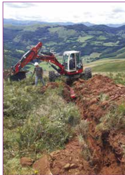
Alimentation électrique d'une antenne de téléphonie en terrain accidenté à Hosta
