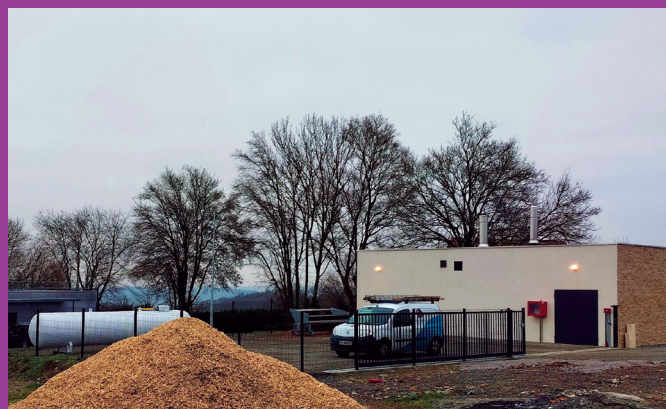
Chaufferie bois de LEMBEYE
