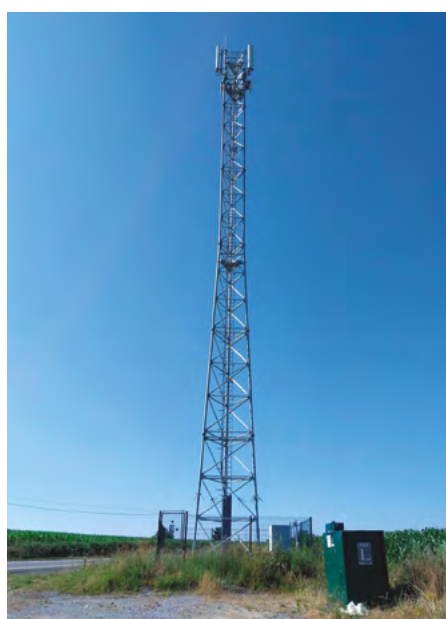
Récent raccordement électrique de l'antenne de téléphonie de MONASSUT
