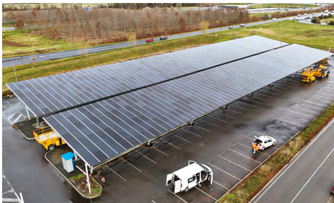
Centrale photovoltaïque sur le parking de covoiturage de Lescar
